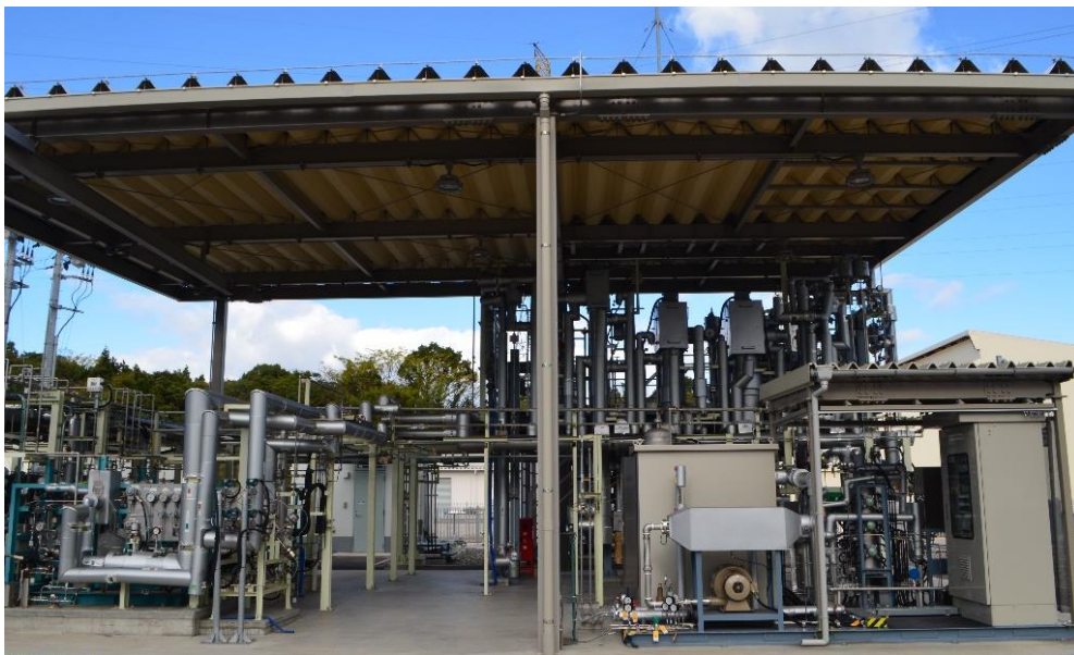
図1 カーボンリサイクル実証研究拠点内ベンチ試験設備外観
