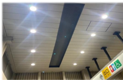
《駅構内LED照明》
