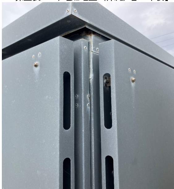
【左：ZAM 裸塗装レス】配電盤 (沖縄) 22 年後
