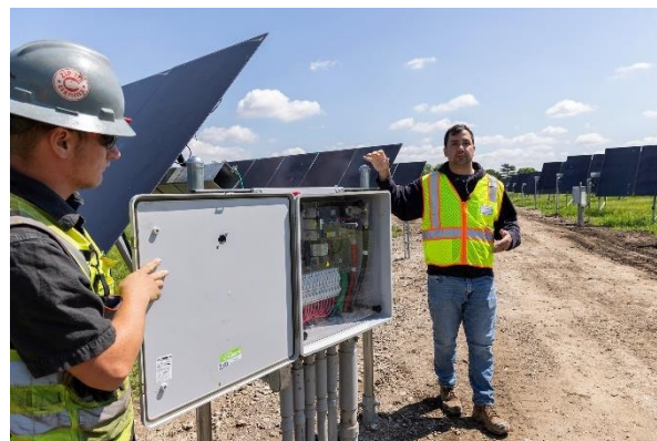
発電所の様子
