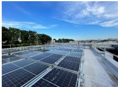
太陽光発電設備
