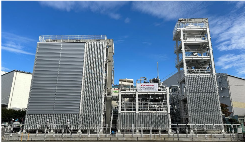
神戸工場に整備した CO 2 分離回収技術の実証設備
