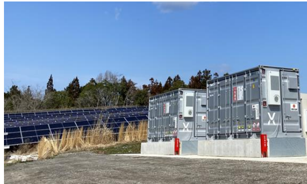
対象の蓄電池併設型太陽光発電所
