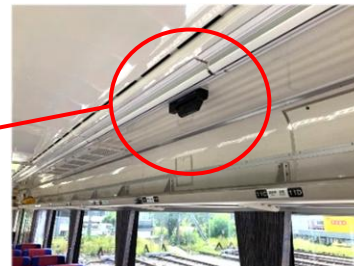
<車内の設置状況>
