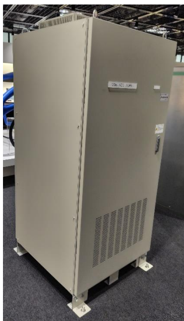
【スーパーダイマ GB 製配電盤】
