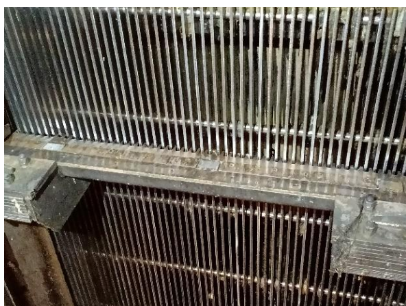
写真1. スクリーンおよびレーキ
