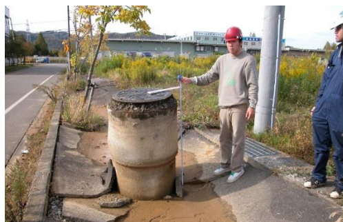
液状化現象によるマンホールの浮き上がり被害
