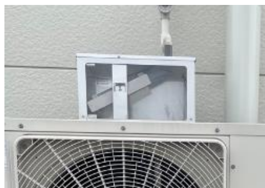
◆ドレン水活用
