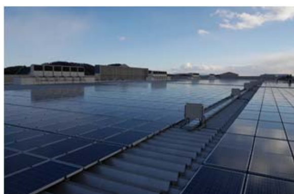
(小売店舗屋根に設置した太陽光発電システム)
