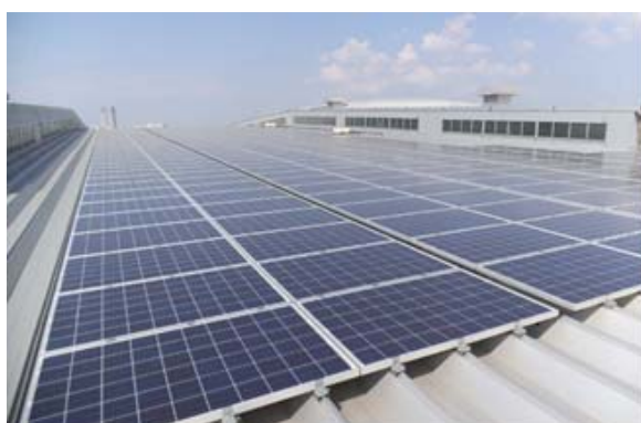
(倉庫屋根に設置した太陽光発電システム)
