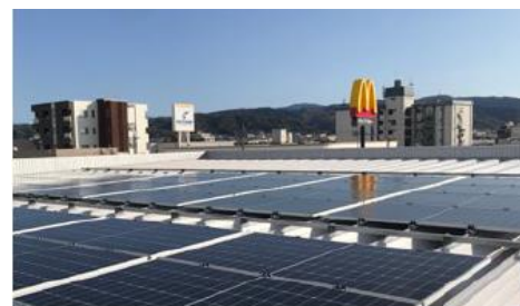
<店舗屋根の太陽光パネル>
