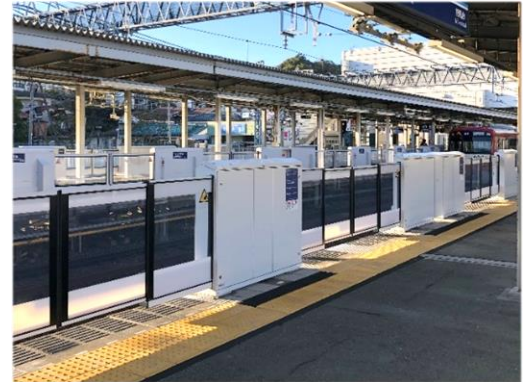
< 設置例（金沢文庫駅下りホーム） >
